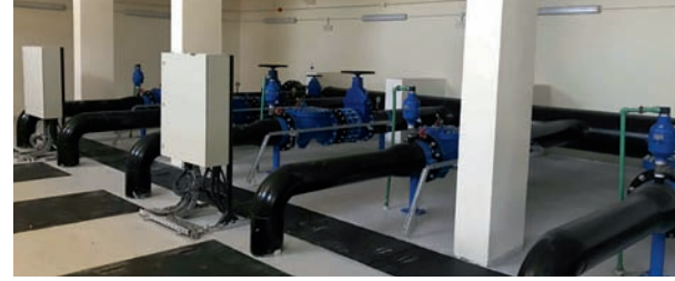
تجهيزات صرف صحي - صور
