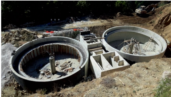
محطة معالجة صرف صحي - الباروك
