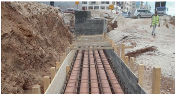
خط التجميع الساحلي الرئيسي لمعالجة مياه الصرف الصحي - طرابلس
