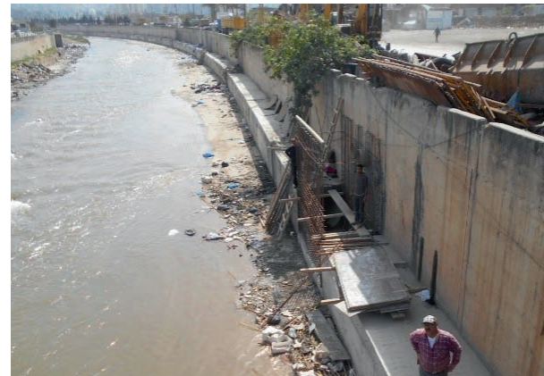
خط التجميع الساحلي الرئيسي لمعالجة مياه الصرف الصحي - طرابلس
